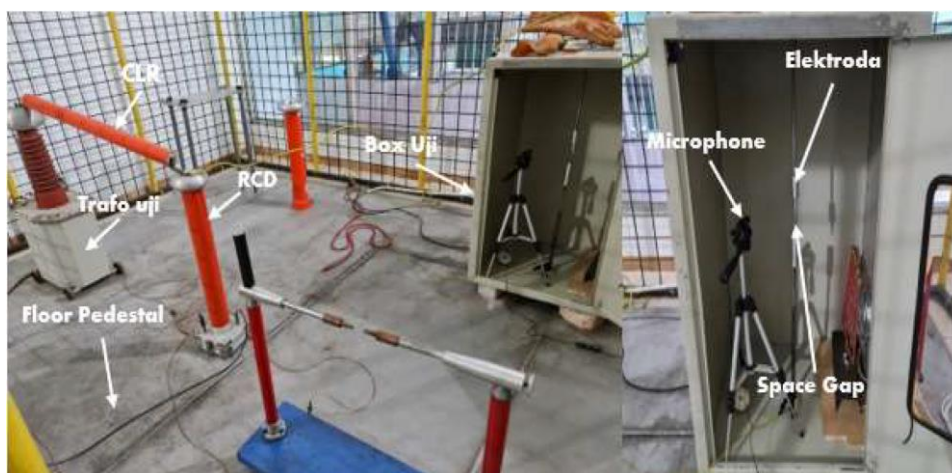
Gambar 1. Prototype Laboratorium Pengujian Suhu terhadap Breakdown Voltage dan Kelembaban Isolator (FIKRI & CHRISTIONO, 2022).
